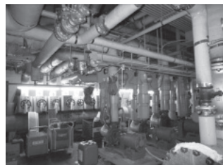
機械室：配管・ダクト状況
