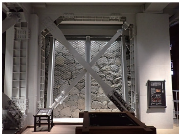
小天守地下1階の制振ダンパー
